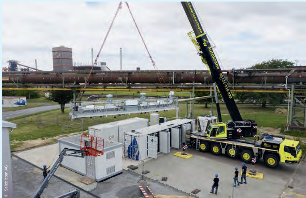
Die HT-Elektrolyse-Anlage (direkt hinter dem Autokran) braucht nicht mehr Fläche als ein 40-Fuß-Container.
