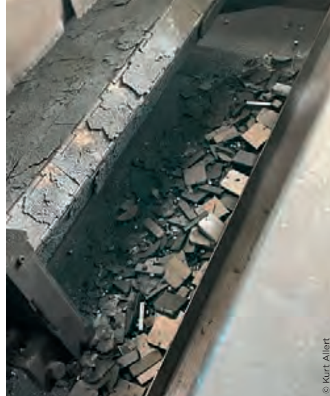
Das Ersatzförderband von Kurt Allert GmbH &amp; Co. KG in der Lasermaschine
